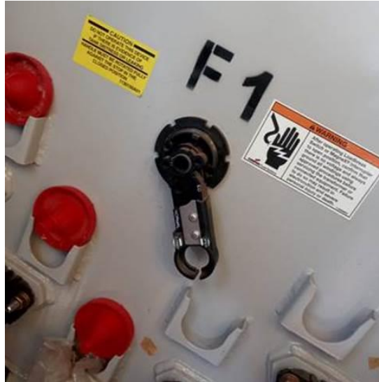
Figura 12: Imagem real do MagneX em um transformador ITB.
